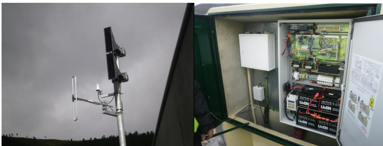
Figura 6 – Pormenor do dispositivo sonoro instalado na ZAS (Camba), sirenes e hardware.
